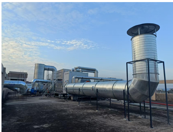
净化处理后排放管道
