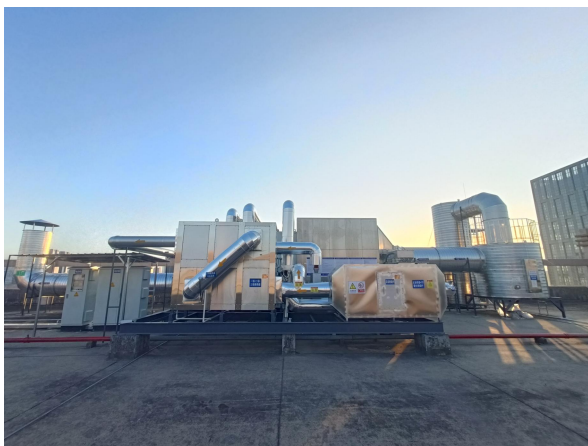
催化燃烧（CO）装置、换热系统
